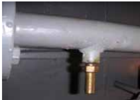
FOT. 4. SYSTEM ZEWNĘTRZNEGO zraszania komory amunicyjnej wodą
