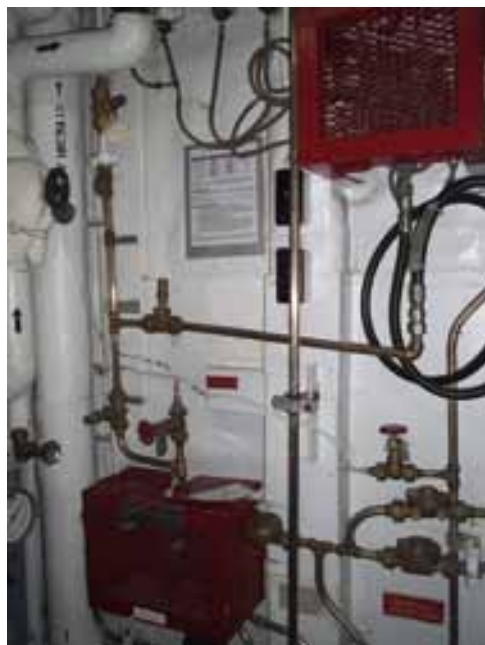
FOT. 3. INSTALACJA W KOMORZE
